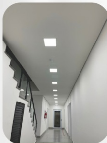
Forro em Drywall
